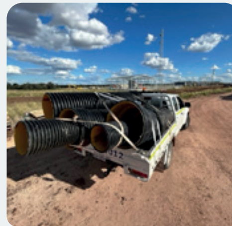
Les tuyaux Blaxmax ont été collectés pour être utilisés comme traversées de route.
