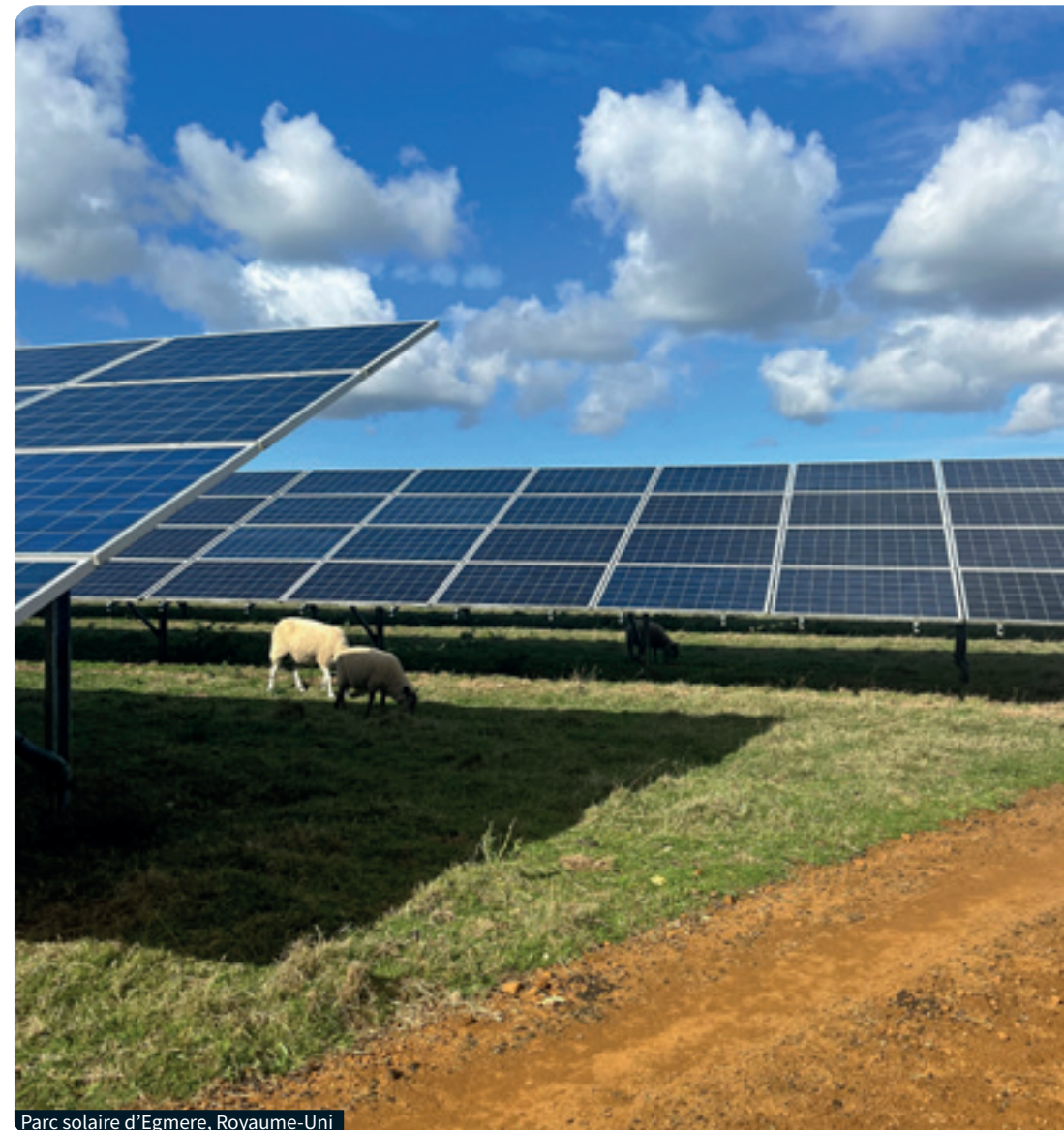
Parc solaire d'Egmere, Royaume-Uni
